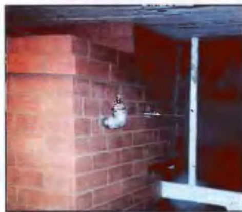
Боров, ведущий к наружной трубе.
